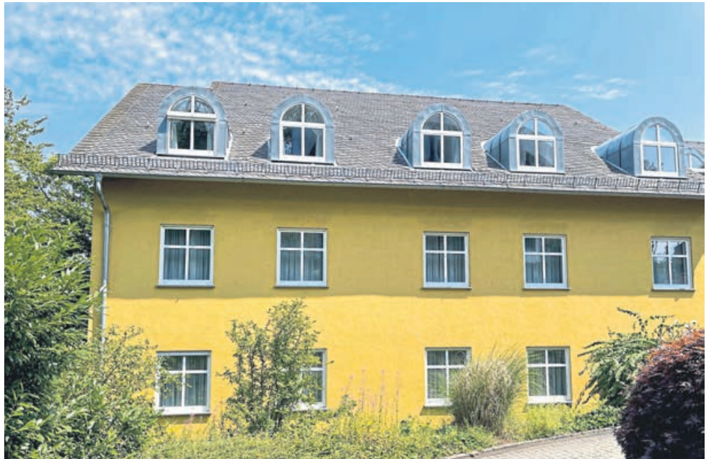
Das Haus Weilburg, ehemals von der ADG als Hotel genutzt, wird umgebaut. Hier werden 25 geförderte, bezahlbare Wohnungen entstehen – nachhaltig, innenstadtnah und zu attraktiven Mietkonditionen. Partner für das Objekt ist das Architekturbüro Buschner in Montabaur. Foto: Architekturbüro Buschner
